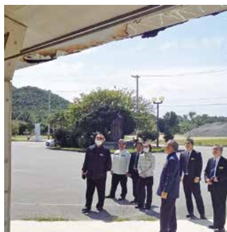
腐食箇所確認の様子
