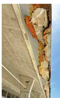
軒下腐食箇所
