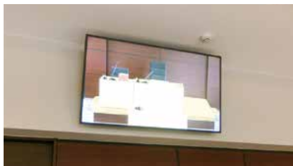
③ モニター 議場内にモニターが設置され、議会中の様子を見ることができます。
